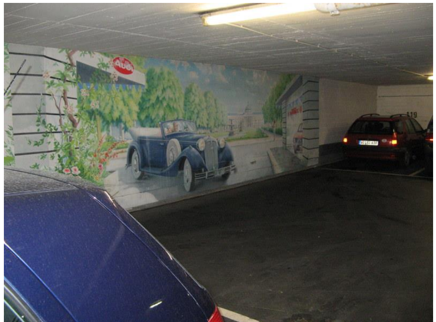
Parkhäuser der 70er und 80er Jahre haben häufig eine niedrige Deckenhöhe, sind dunkel und verschmutzt. Versuche einer Behübschung – wie hier durch Wandmalereien im Parkhaus City-Passage in Wiesbaden – sind meist nur oberflächliche Kosmetik.
